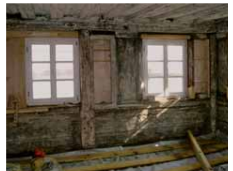
▲ Schadhafte Holzteile wurden ersetzt, die Wandschränke ergänzt und der alte Dielenboden zum späteren Wiedereinbau zwischengelagert. Darunter befinden sich Teile des ursprünglichen Gipsestriches, der unter dem neuen Bodenaufbau erhalten bleibt.
