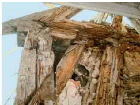
und Schäden im Detail an der Westfassade des Haupt- hauses.
