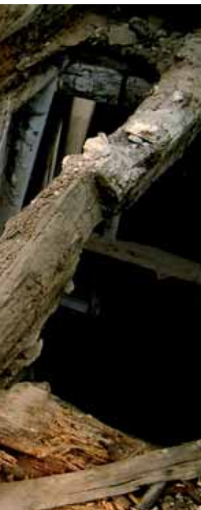
◀ Detail der Schäden an der westlichen Giebelwand.
