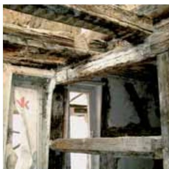
▲ Haupthaus, Schäden an den Deckenbalken in der Südwestecke.
