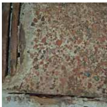
▲ Abb. 7 Mittelalterlicher Gipsestrich (gereinigter Zustand) mit zerkleinerten Ziegel- und wohl Schlackezusätzen auf Spaltholzrost.
