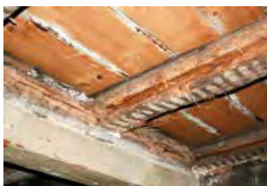
▲ Geöffnete barockisierte Decke im Obergeschoss: Seitlich der belassenen Balken sind die Nuten für die ehemals eingeschobenen Bretter erkennbar. Auch hier wurden später Lehmwickel eingeschoben.
