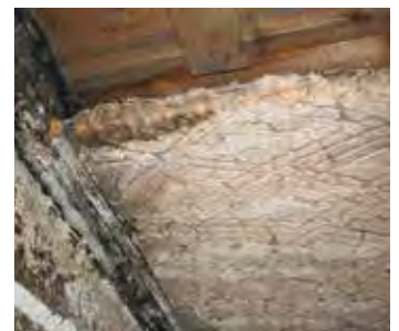
▲ Deckendetail in der Küche im Obergeschoss: Nachträglich wurden Latten an den vorher offenen Originalbalken festgenagelt. Die mit Lehm-Stroh-Gemisch umwickelten Staken legte man einfach oben auf.
