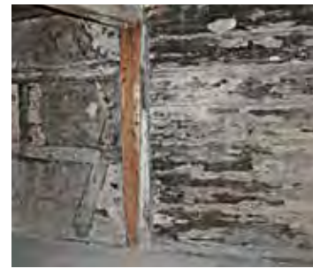
▲ Freigelegte Bohlenwand im Obergeschoss, im Verlauf der nördlichen Außenwand, die nach Westen als Fachwerkwand weiterläuft.
