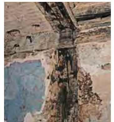
▲ Der einzige noch vorhandene Fachwerkständer der Bauzeit innerhalb der nördlichen Außenwand im Erdgeschoss. In ihm war ein Kopfband zum Deckenbalken im schräg nach oben verlaufenden Zapfenloch eingebunden.
