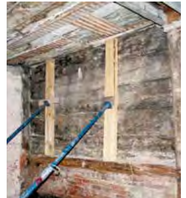
▲ Der originale Bohlenwandabschnitt an der nördlichen Außenwand des Erdgeschosses nach der Freilegung (und Stützicherung).
