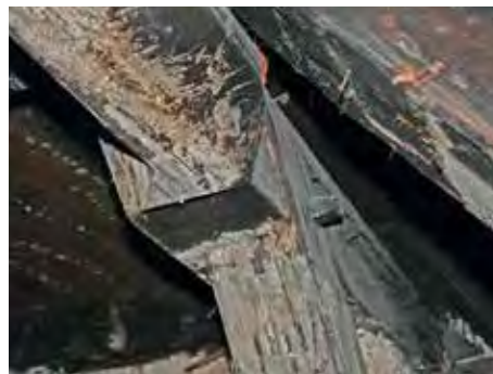
▲ Geniales Baudetail einer Stuhlkonstruktion: Die Sparren lagen vollflächig auf, die Pfetten konnten in die Ständer der Giebelaußenwände eingezapft werden.
